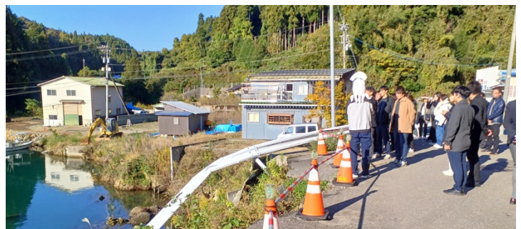
地盤沈下で生活道路が損壊した現場を視察し、復旧・復興に向けた課題を確認
